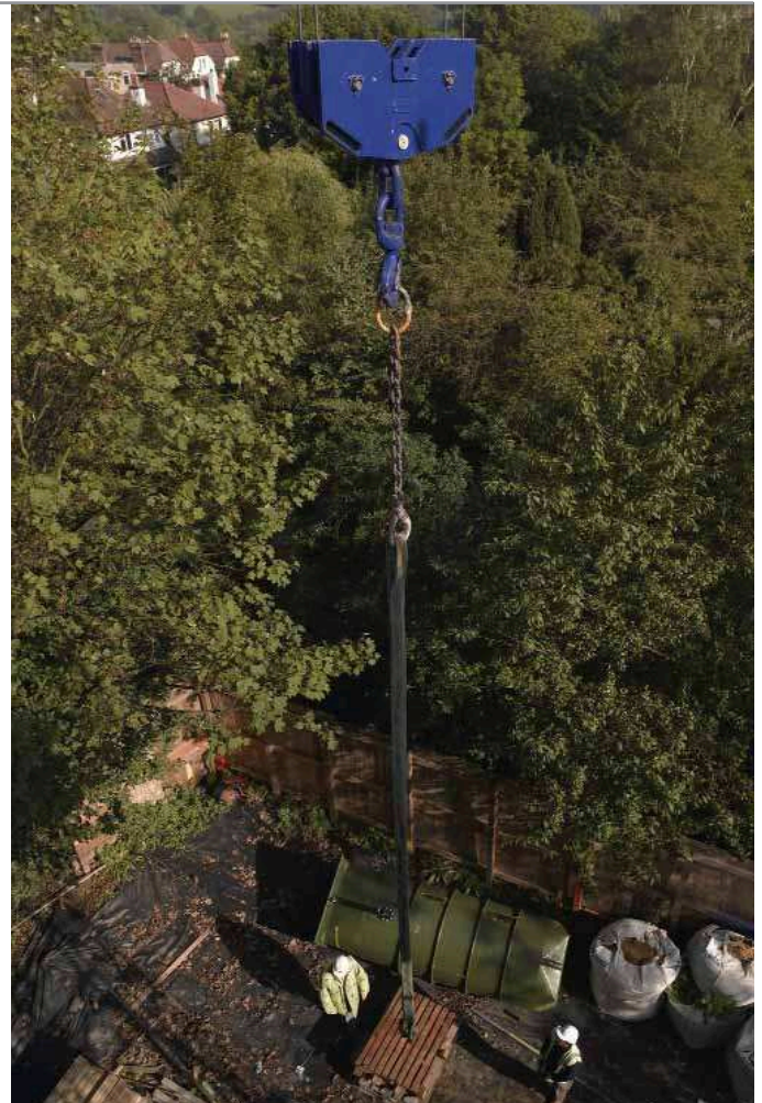
Im Gegensatz zu anderen Hub- und Transportmaschinen kann der Selbstmontagekran alle Bereiche der Baustelle erreichen.
